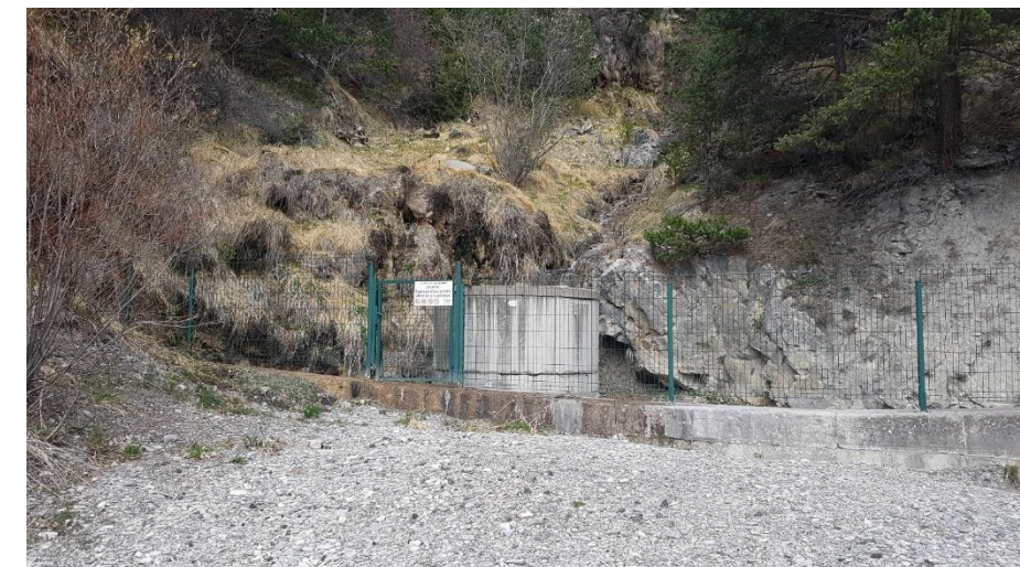
Photographie 9. Captage du torrent des Péous
